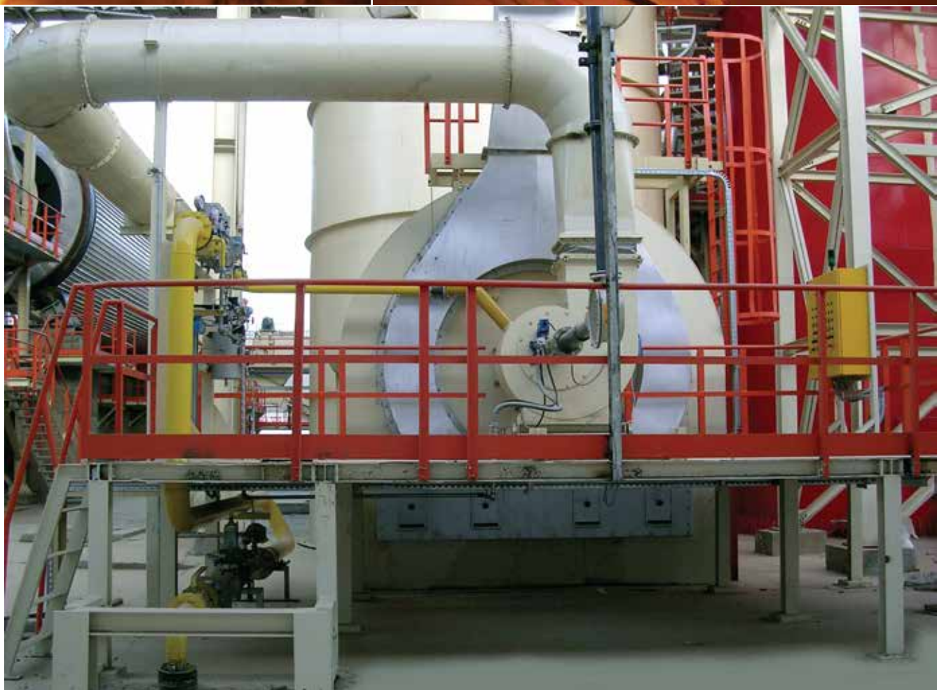
木屑燃烧器内部燃烧情况 Combustion inside the wood dust burner
