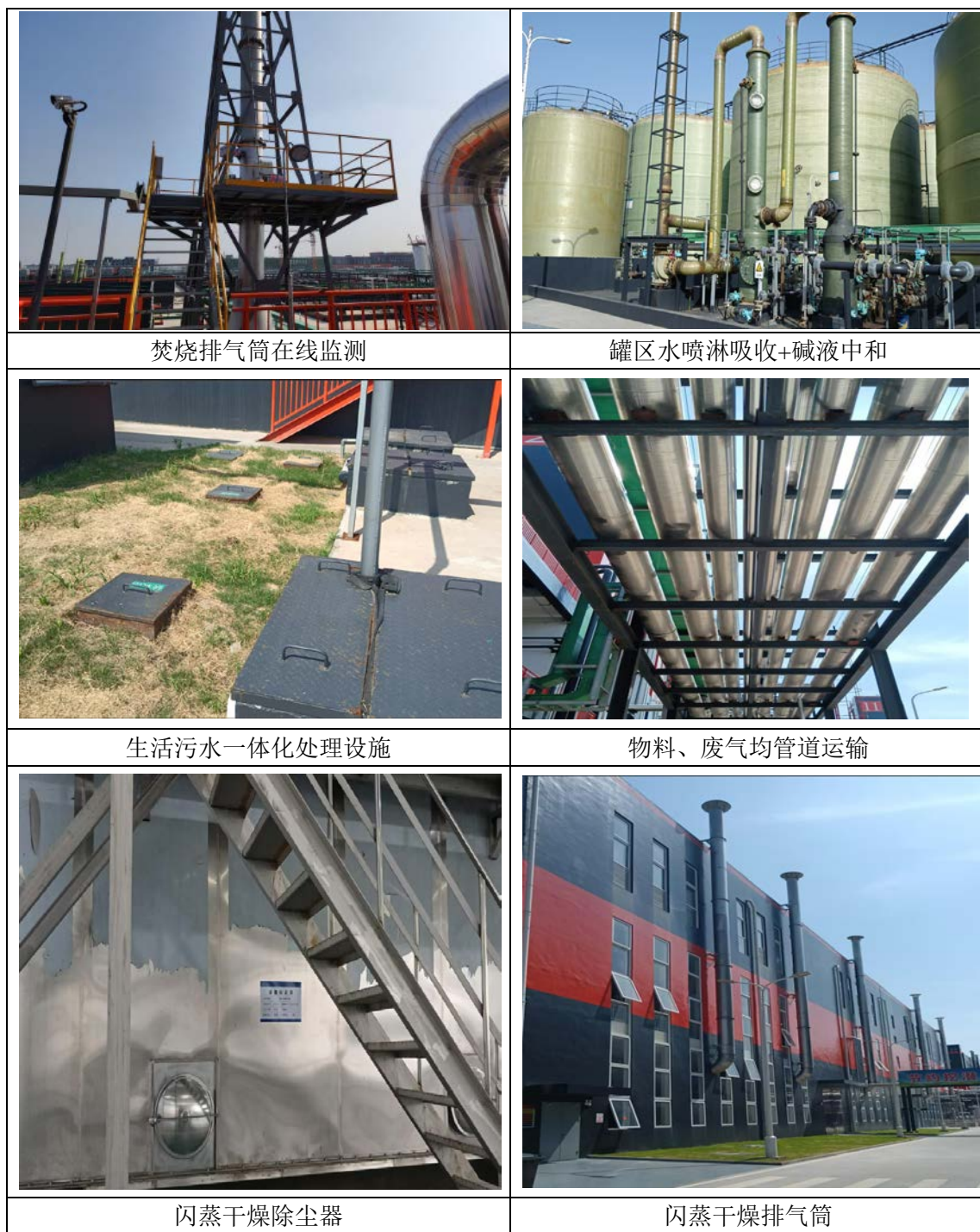
图 4.1-6 废气处理设施现场照片
