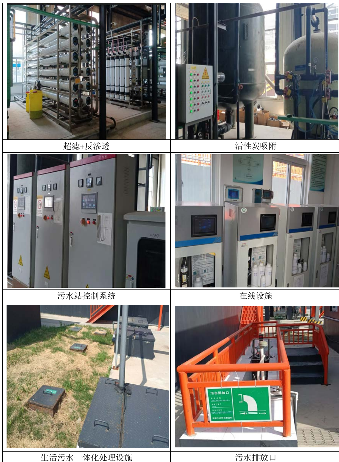
图 4.1-1 废水处理设施现场照片
