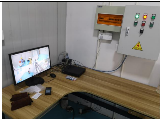
图 6-2 探伤室监控装置
