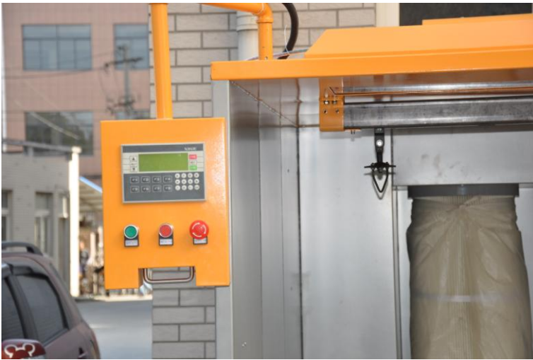
PLC control para nueva cabina.
